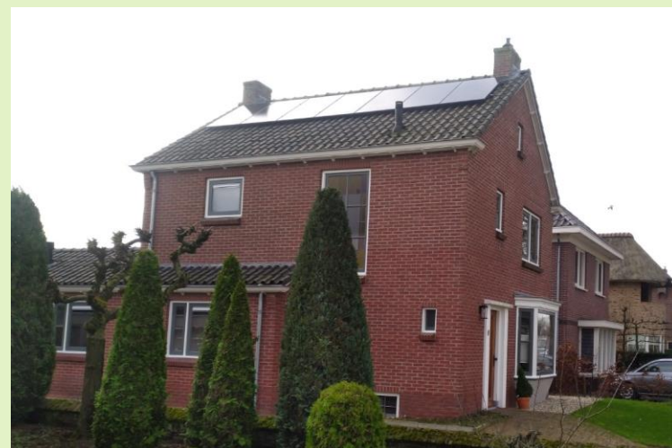
7st PV panelen op NO dakvlak (opwek 2000kWh in 2022)
